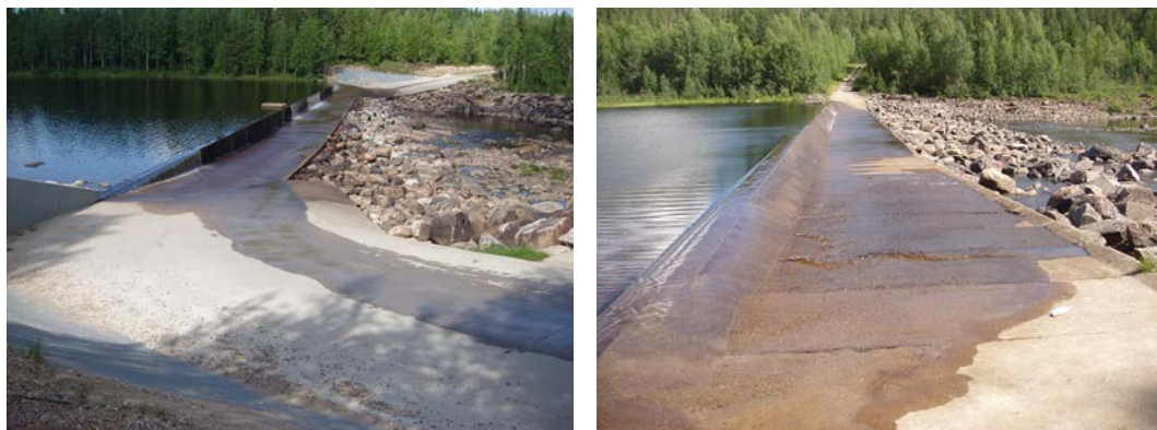
Foto 5. Till vänster, spegeldamm som dämmer upp Vuollerimselet. Till höger, spegeldamm vid Padjerim. Foton: Patrik Olofsson, Länsstyrelsen 2007.
