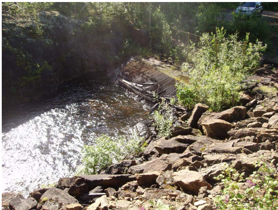
Foto 11. Kaltisbäckens inlopp i tunneln som leder vattnet uppströms Messaures kraftverk. Foto: Patrik Olofsson, Länsstyrelsen, 2007.
