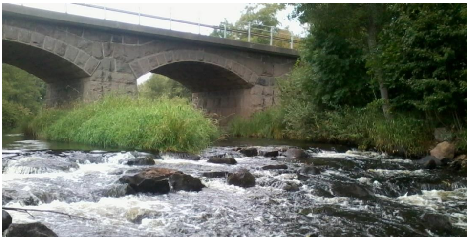
Figur 2. Den övre delen av elfiskelokalen ”Tingebro” i Emån vid elfisket hösten 2013. Notera skillnaderna i vattenmiljön uppströms respektive nedströms nacken (foto: Niklas Nilsson, Jönköpings Fiskeribiologi AB).
